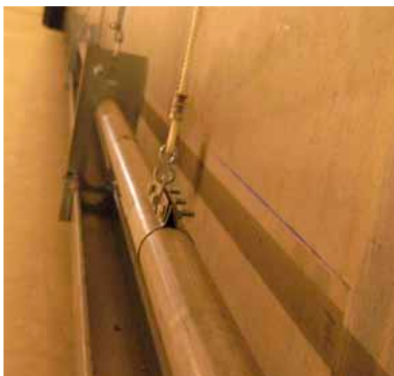
Hanefodringssystem langs væggen i den nye stald.
