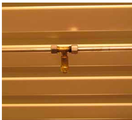
Dyse til vandforstøvning som led i det avancerede højtrykskøle-anlæg, der også indgår i brandsikring af stalden.
